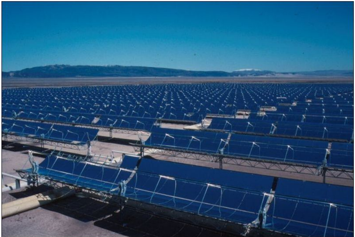
Photo 1-1-b: Concentrateurs cylindro-paraboliques de type LS3 à Kramer Junction, Californie
